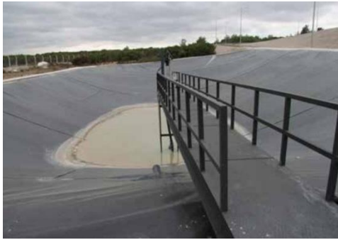
Resim 3.3. İzmir/ Bergama Katı Atık Tesisi (İller Bankası A.Ş. 2015 Faaliyet Raporu)
