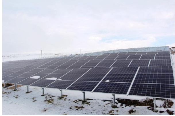
Resim 3.18. Bayburt Güneş Enerji Santrali (İnternet: Bayburt Belediyesi)
