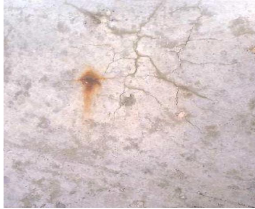
Resim 1.2. Donatı korozyonu sonucu pas payının beton yüzeyine sızması [3]
