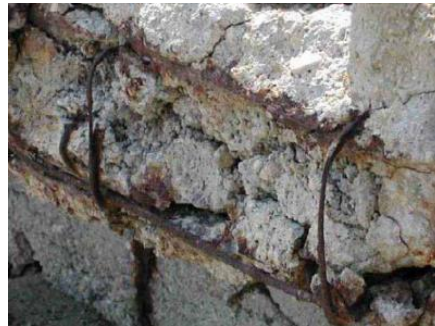
Resim 1.1. Korozyon sonucu donatının zarar görmesi [3]
