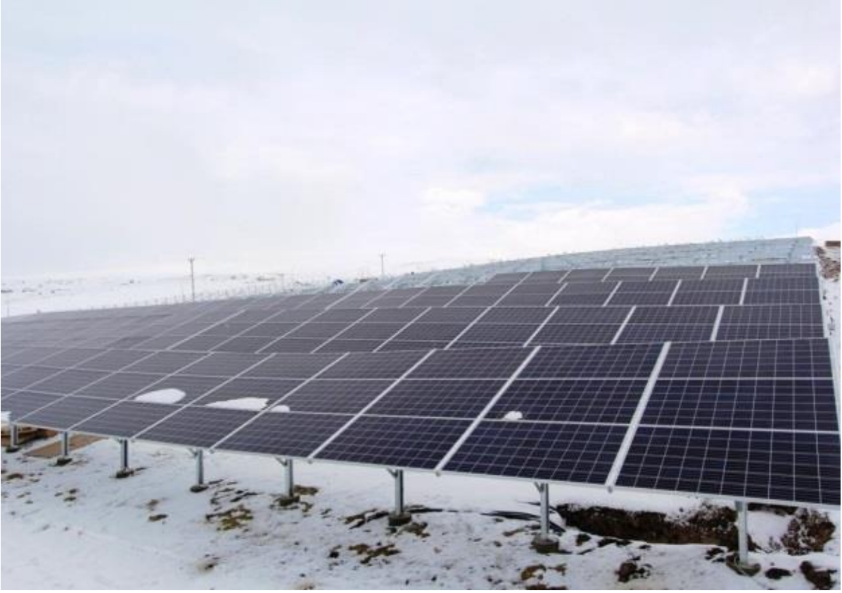
Resim 3.9. Bayburt Güneş Enerji Santrali (İnternet: Bayburt Belediyesi)
