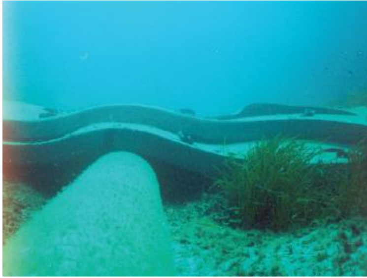
Resim 4.1. Bileşik beton blok örtü ile korunan boru hattı
