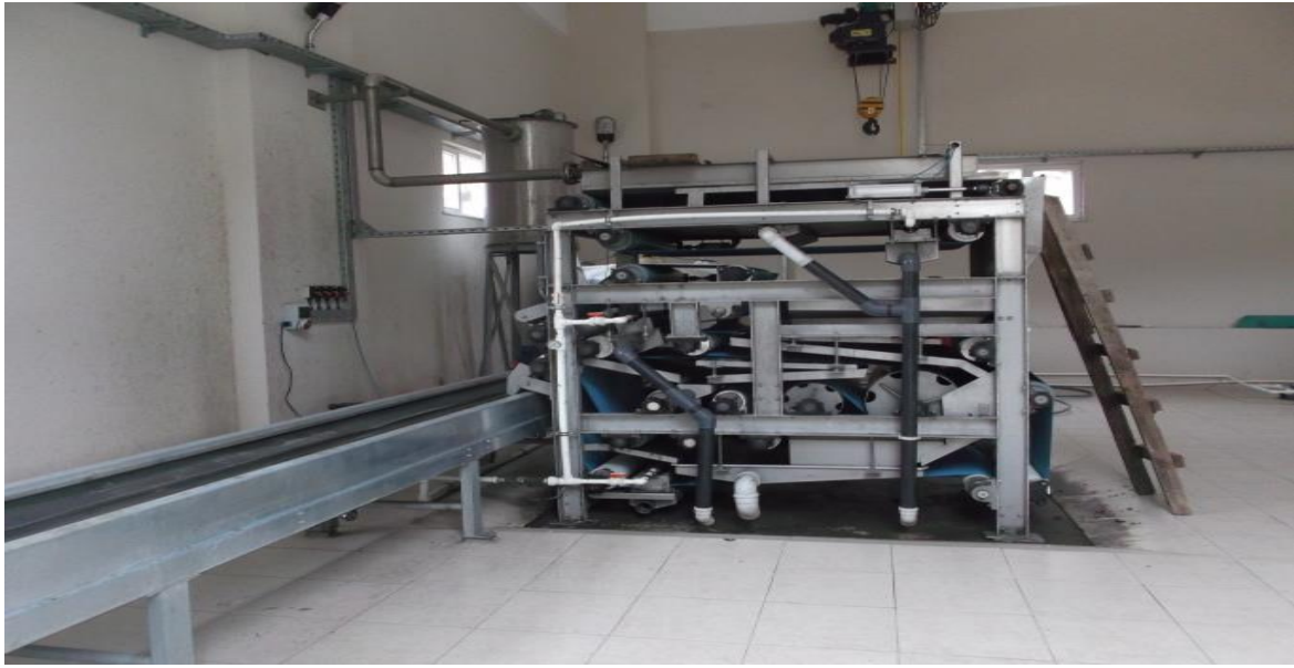
Resim 6.1. Gümüşhane AAT belt-press çamur susuzlaştırma ünitesinden görünüm
