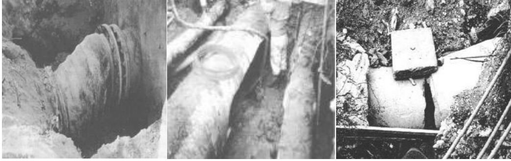
Şekil 3.13. Adapazarı içmesuyu ve atık su hattında sıvılaşma Sonucu oluşmuş hasarlar [78]
