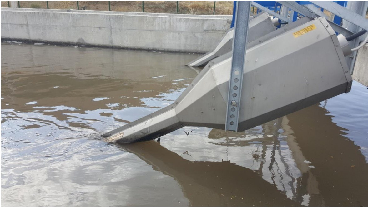
Resim 5.2. Refahiye (Erzincan) AAT jet havalandırıcıların atıksudaki konumu
