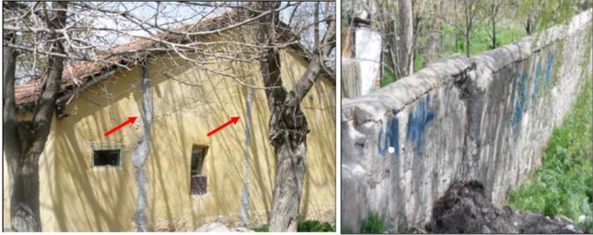
Resim 3.1. Zemindeki şişmeye bağlı tek katlı yapıda ve bahçe duvarında meydana gelen çatlama (Öztürk, 2015)
