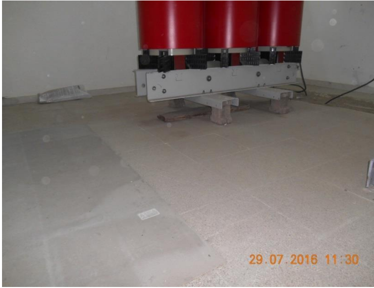
Resim 3.5. Erciş (VAN) otogar yapım işinde 630 kVA trafo ve 36000 volt izole halı
