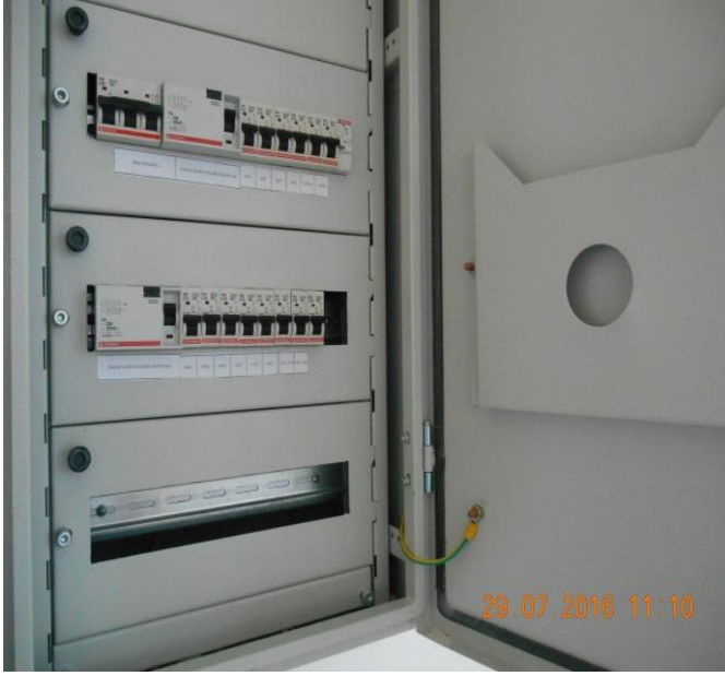
Resim 4.15. Erciş (VAN) otopark yapım işi tali pano koruma topraklaması
