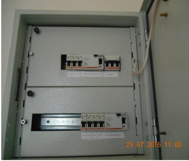
Resim 4.8. Erciş (VAN) otopark yapım işinde tali panoda kullanılan 30 mA anma kaçak akım değerine sahip kaçak akım rölesi
