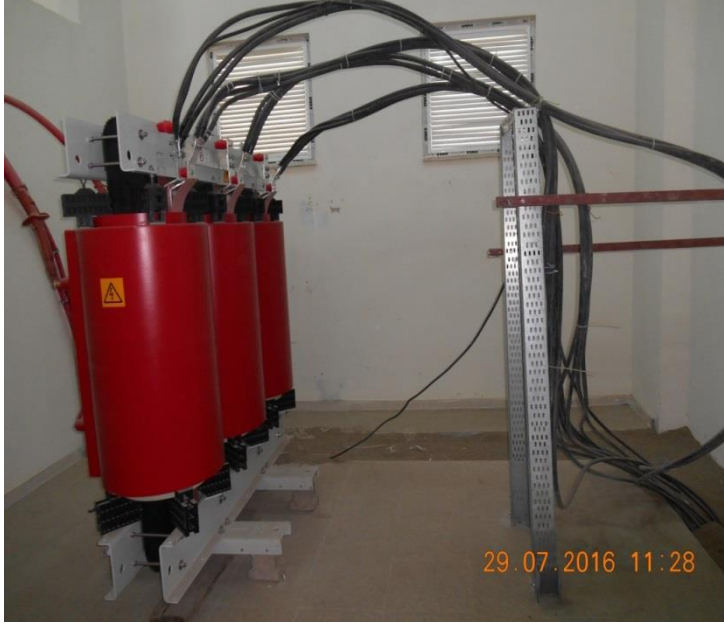
Resim 4.1. Erciş (VAN) otopar yapım işinde kullanılan 630 kVA kuru tip trafo
