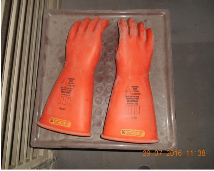
Resim 3.3. Erciş (VAN) otogar yapım işinde trafo odasında bulunan 36000 volt izole eldiven ve izole sehpa
