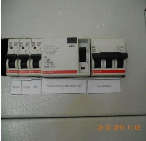
Resim 4.9. Erciş (VAN) otopark yapım işinde tali panoda kullanılan 30 mA anma kaçak akım değerine sahip kaçak akım rölesi
