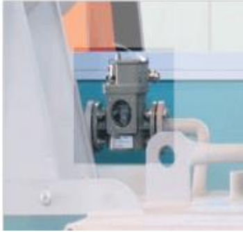
Resim 4.4. Bukolz rölesi ve trafodaki yeri [6]
