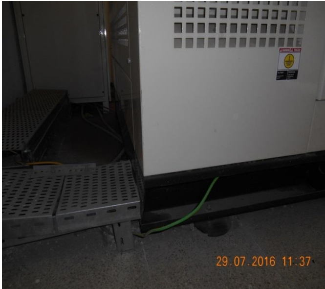
Resim 4.14. Erciş (VAN) Otogar yapım işi jeneratörde koruma topraklaması
