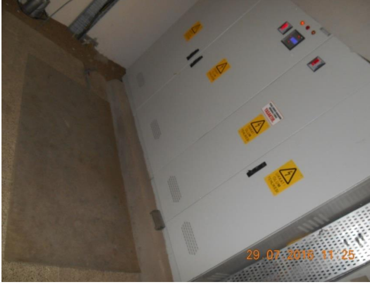
Resim 3.4. Erciş (VAN) otogar yapım işinde AG (Alçak Gerilim) panosu önünde bulunan 36000 volt izole halı
