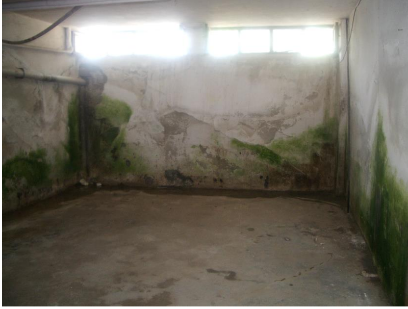
Resim 1.6. Bodrum kat duvarlarında oluşan hasarlar.
