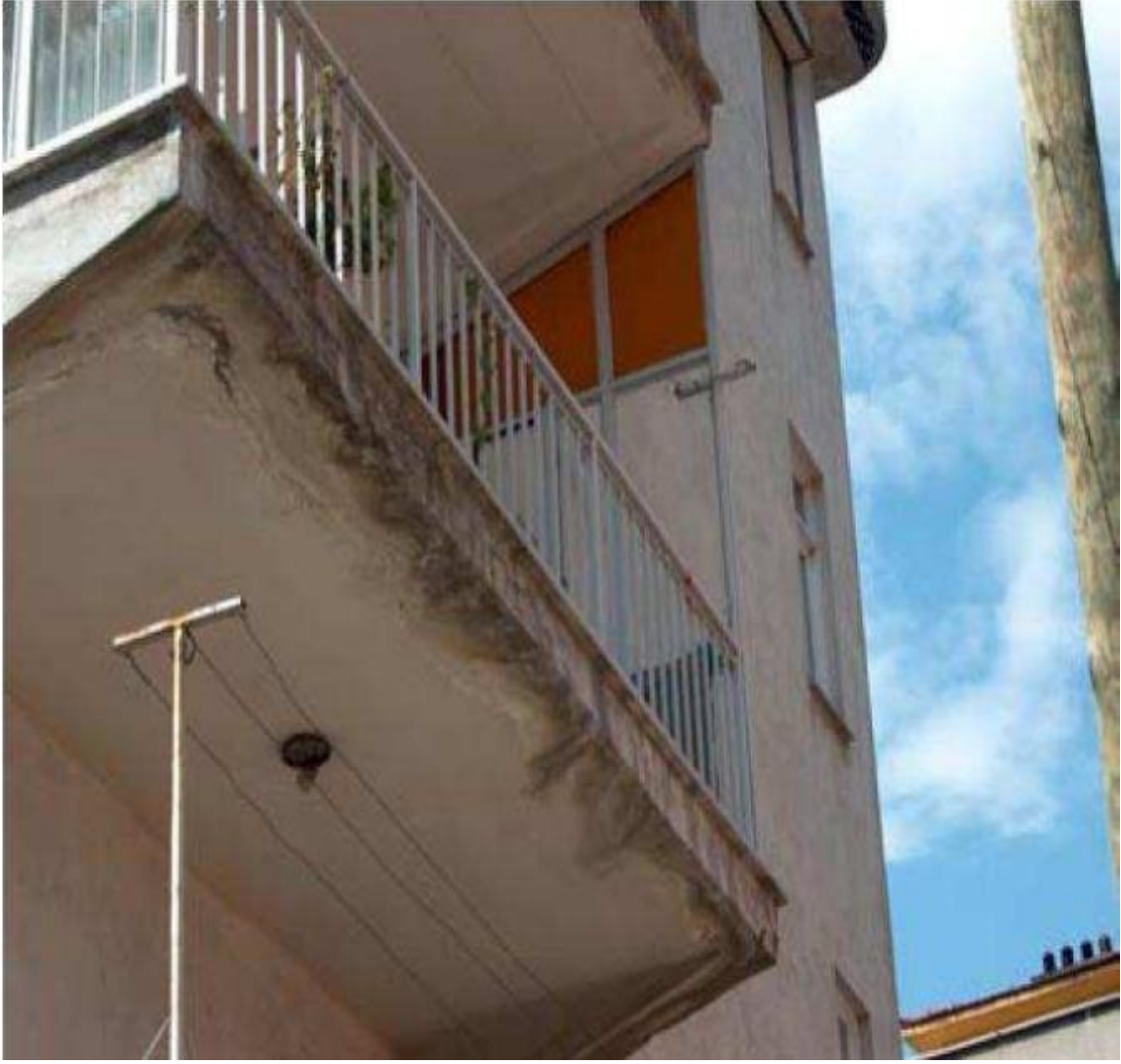
Resim 1.1. Damlalık yapılmadığı için bina cephesinde oluşan hasar.
