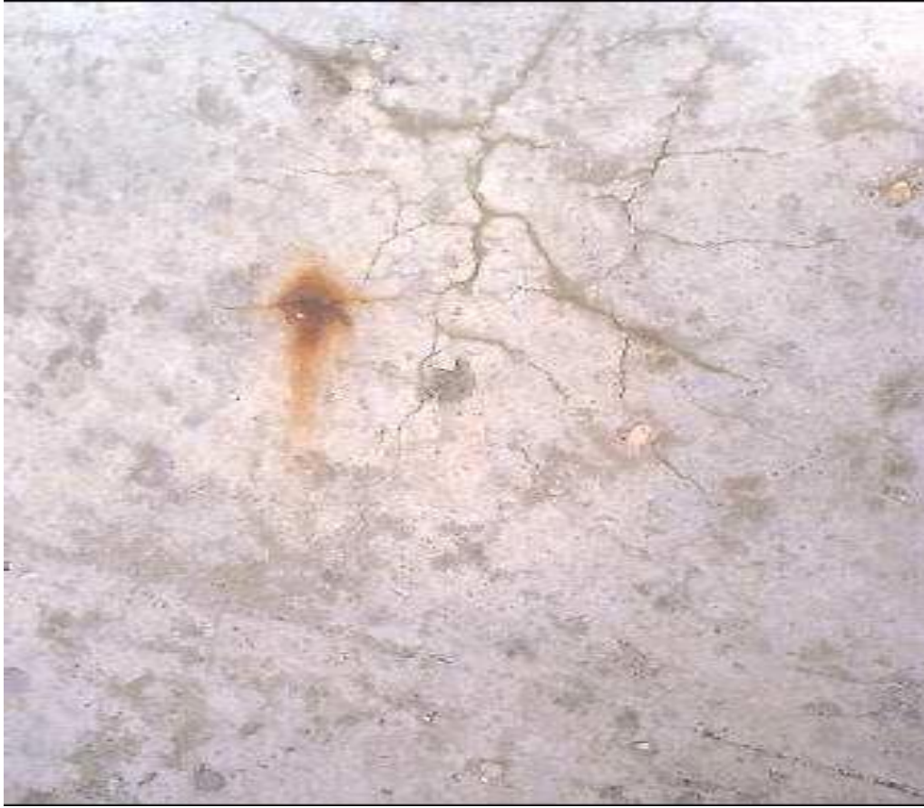
Resim 1.3. Donatı korozyonu sonucu pas tabakasının beton yüzeyine sızması.
