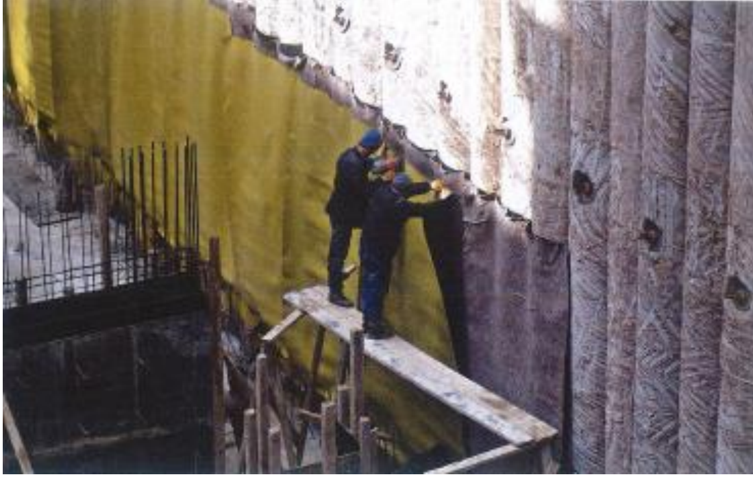
Resim 4.2. İksa sistemine su yalıtımı, yanlış uygulama.
