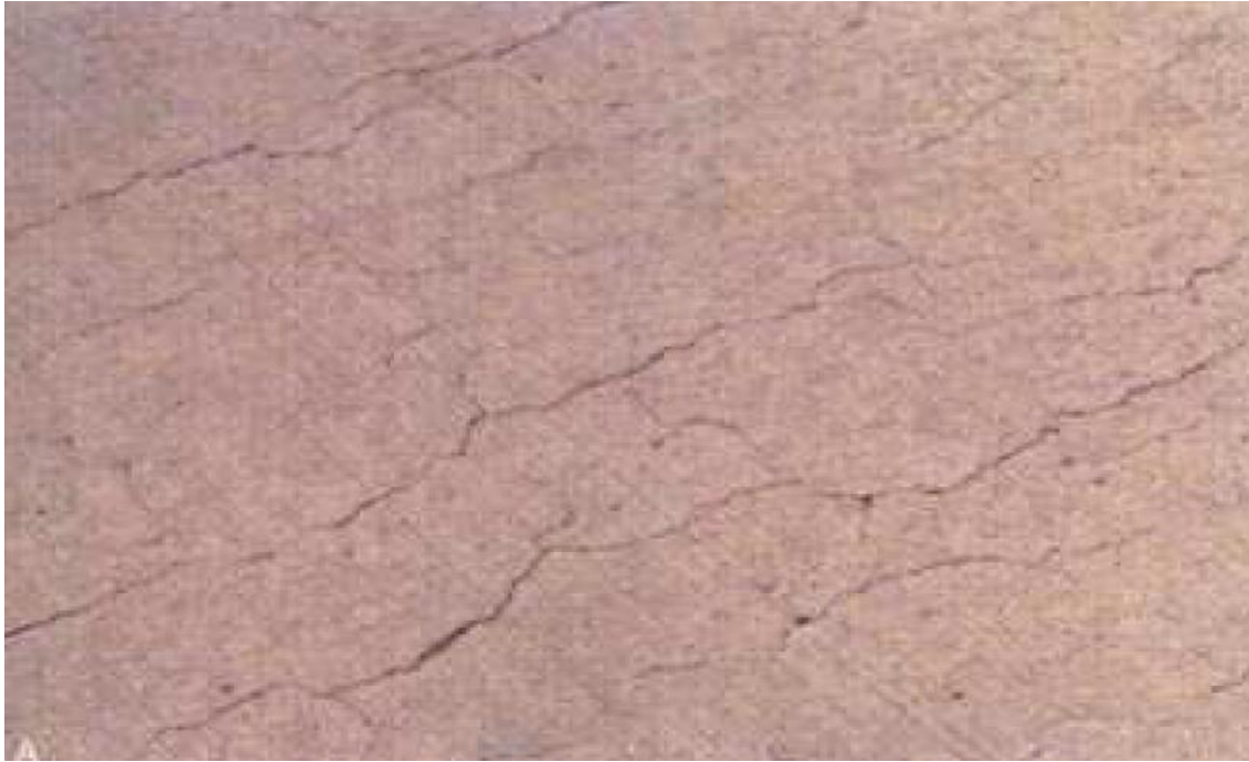
Resim 1.7. Alkali-silika tepkimesi hasarına bağlı olarak oluşan çatlaklar.
