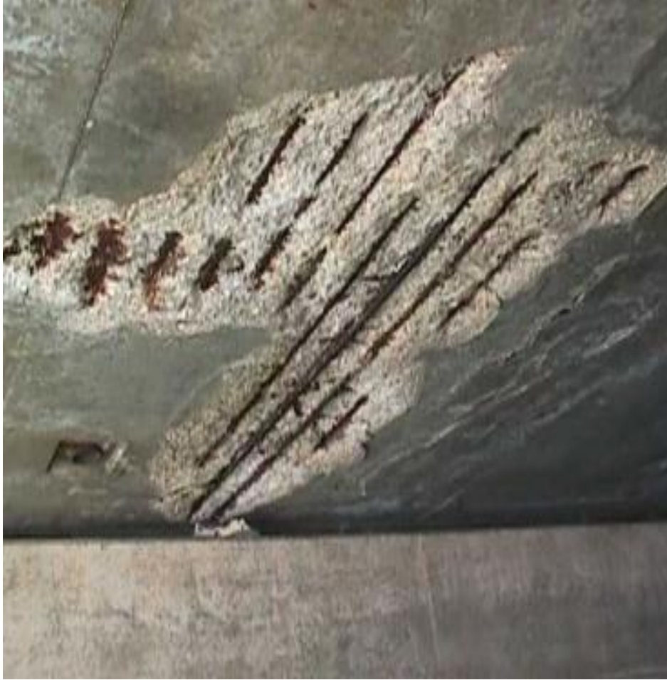
Resim 1.2. Donatı korozyonu sonucu donatının aıa ıkması.
