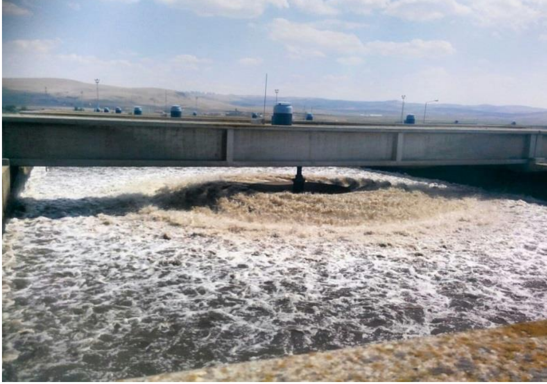
Resim 4.3. Tatlar AAT havalandırma havuzu
