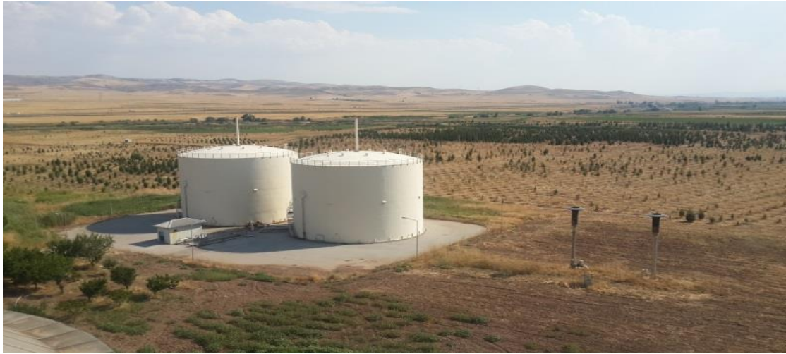
Resim 4.6. Tatlar AAT gaz depolama tankları
