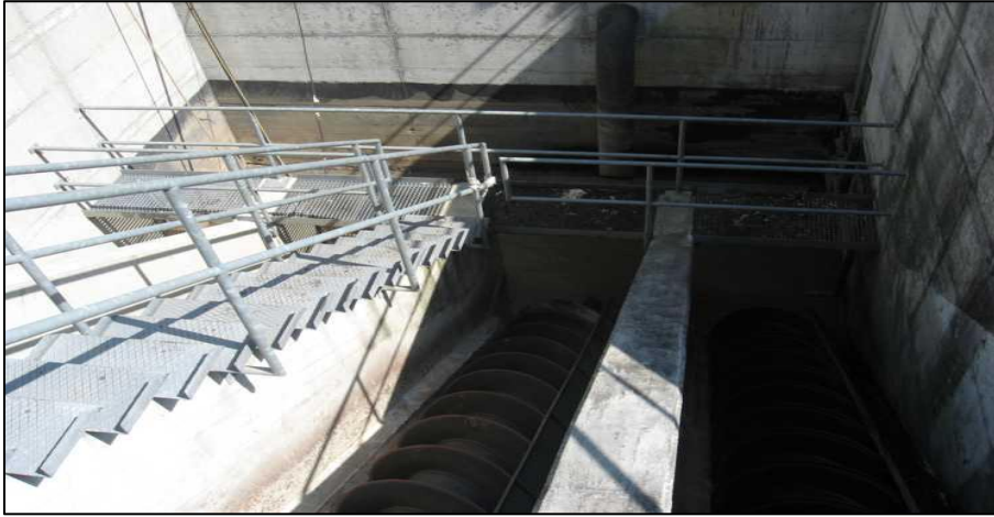
Resim 2.4. Atıksu terfi ünitesi [16]
