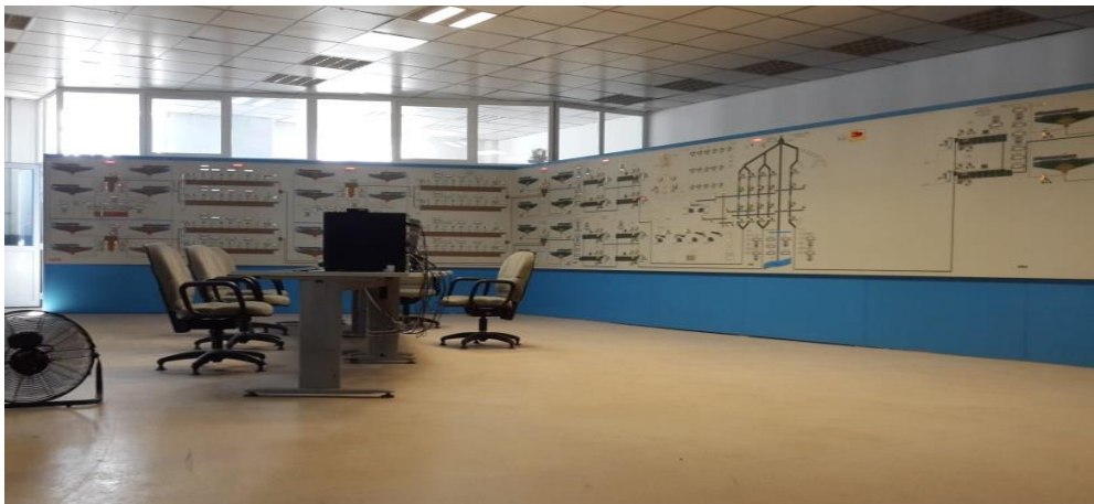
Resim 4.11 Tatlar AAT ana kontrol merkezi
