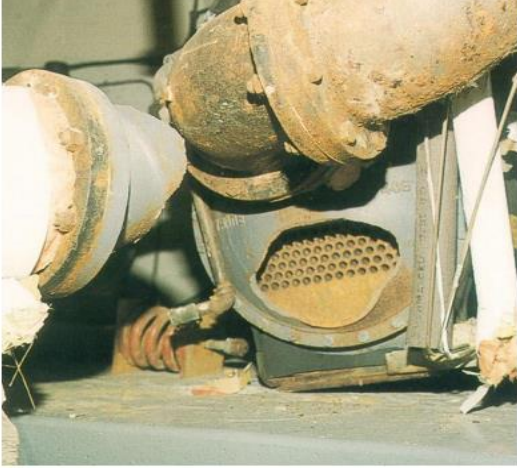
Resim 2.3. Sismik koruma yapılmamış boru bağlantısı [6]
