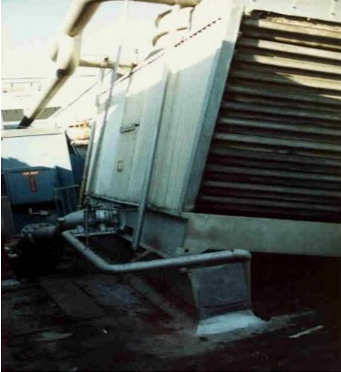
Resim 2.2. Kaide bağlantısı yapılmamış soğutma kulesi [6]
