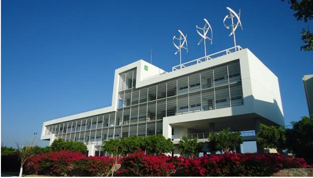
Resim 2.13. Bina montajlı rüzgâr türbini
