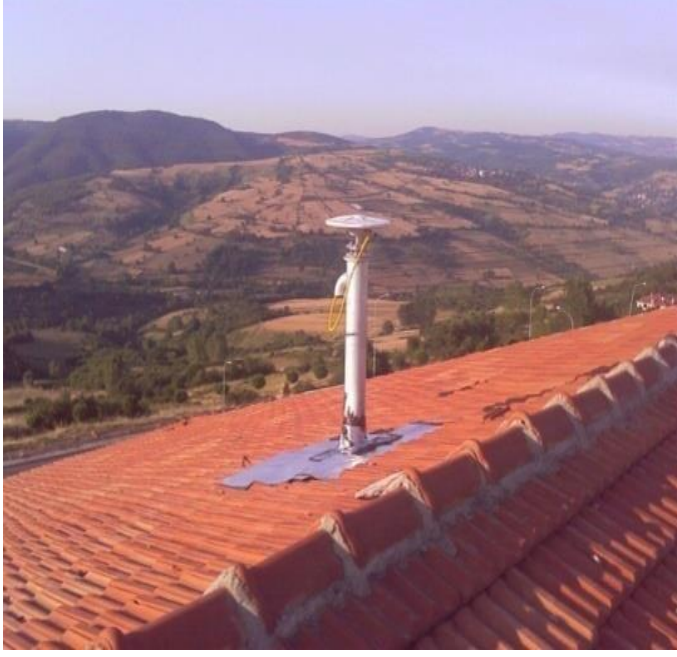
Resim 5.4. Galvanizli çelik tesis (Çatı tabanından 4 m) [41]
