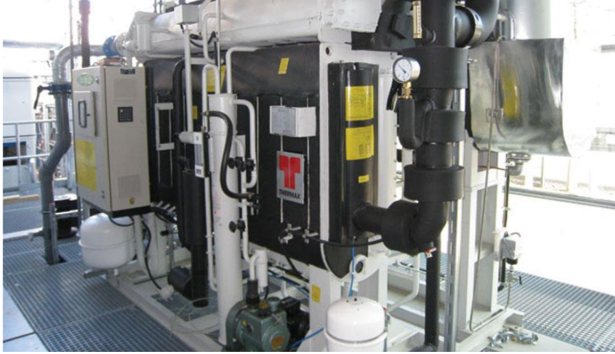
Resim 3.3. Yakıt pili kullanan kojenerasyon santrali örneği
