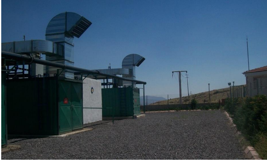
Resim 2.3. Çöp gazı ile çalışan 8,1 MW gücündeki enerji üretim tesisi
