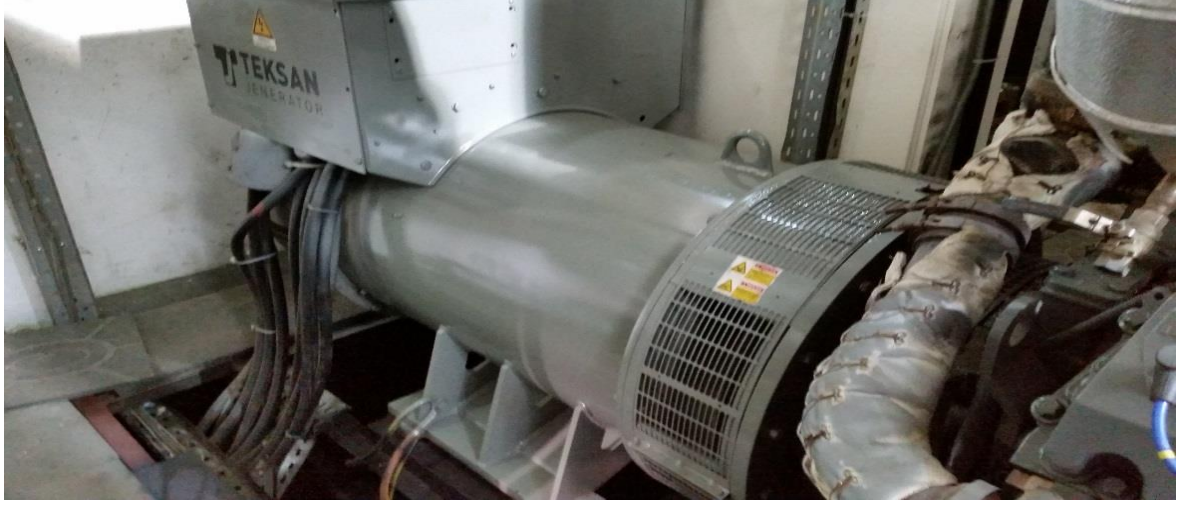
Resim 4.8. ACITY Trijenerasyon tesisi alternatör kısmı
