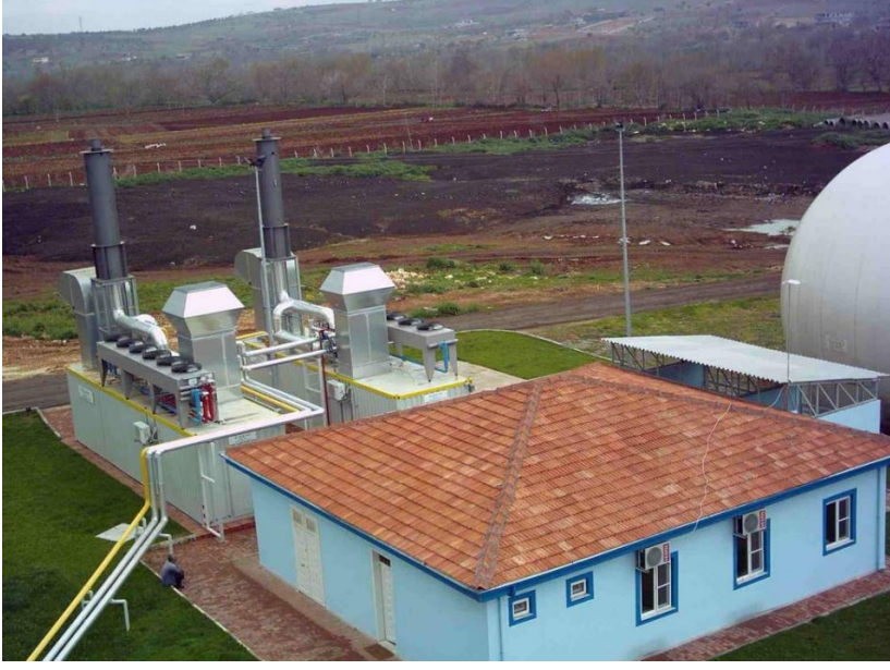
Resim 2.1. Biyogaz ile çalışan 1,8MW'lık GASKİ atıksu arıtma tesisi kojenerasyon tesisi örneği
