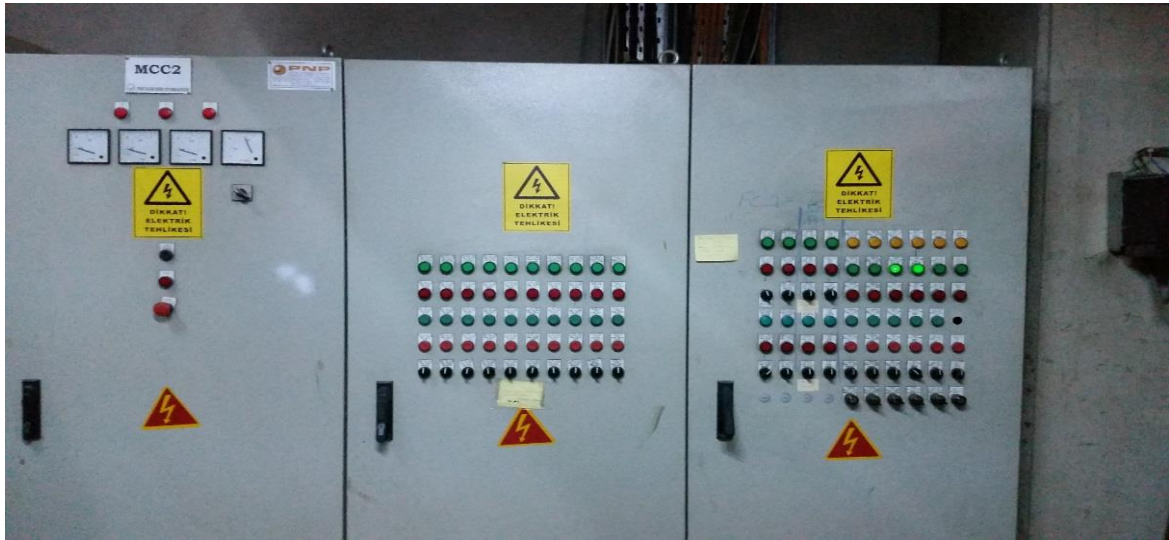
Resim 4.7. ACITY Trijenerasyon tesisi MCC panoları
