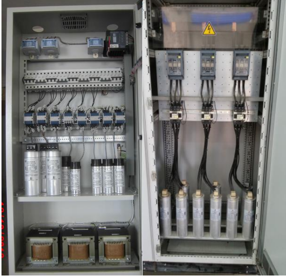
Resim 3.1. İdeal bir kompanzasyon panosu (sol); Gebze A.A.T.'deki kompanzasyon panosu (sağ) (Yazar tarafından fotoğraflanmıştır)
