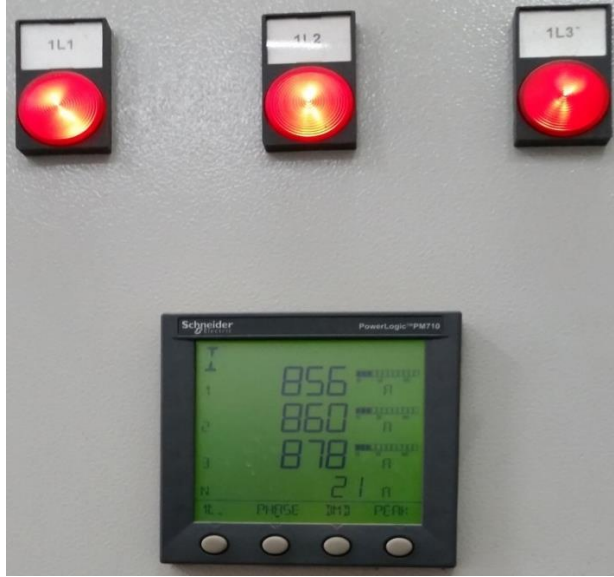
Resim 4.3. Ölçüm öncesinde TR-1'in faz başına amperaj durumu (Yazar tarafından fotoğraflanmıştır)
