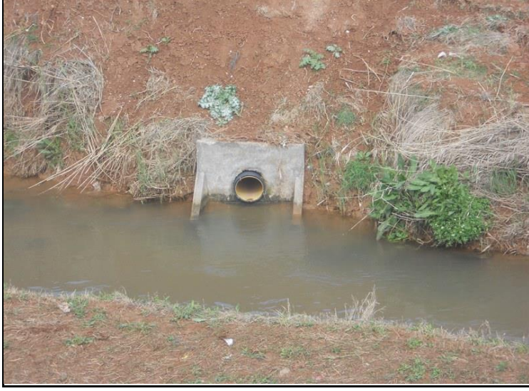
Resim 1.10. Drenaj borusunun fazla suyu akarsuya iletmesi [17]
