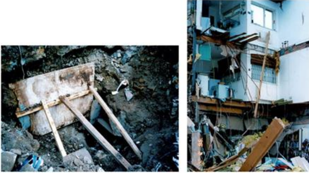
Resim 4.2. Yetersiz iksa uygulaması ve sonucunda oluşan hasar (HSE, 2012: 1)
