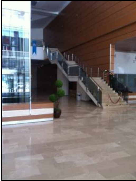
Resim 4.25. Bina içerisinde eksik olan hissedilebilir yüzey uygulaması (yazarın arşivinden)
