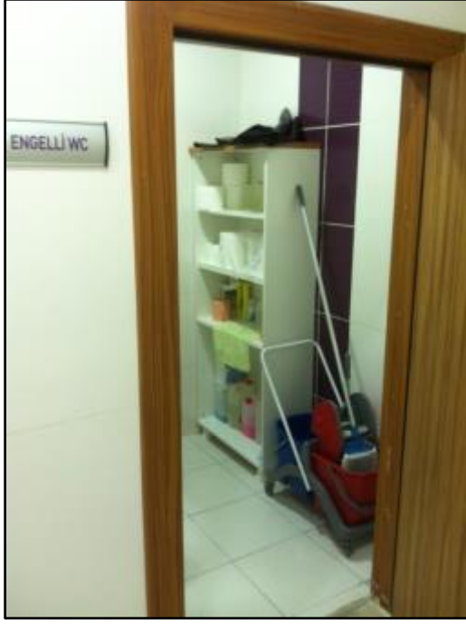
Resim 4.24. Depo olarak kullanılan engelli WC problemi örneği (yazarın arşivinden)
