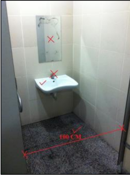
Resim 4.28. Sivas otobüs terminali uygun olmayan batarya ve ayna seçimi (yazarın arşivinden)
