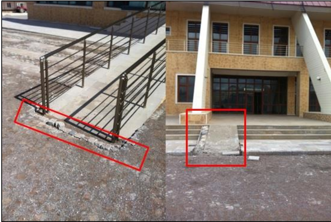
Resim 3.2. Sivas Yıldızdağı kayak merkezi günübirlik tesisi problemlili rampa çözümleri (yazarın arşivinden)
