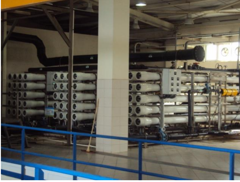
Resim 4. 12. Ters Osmoz membranları üniteleri (3 ünite)
