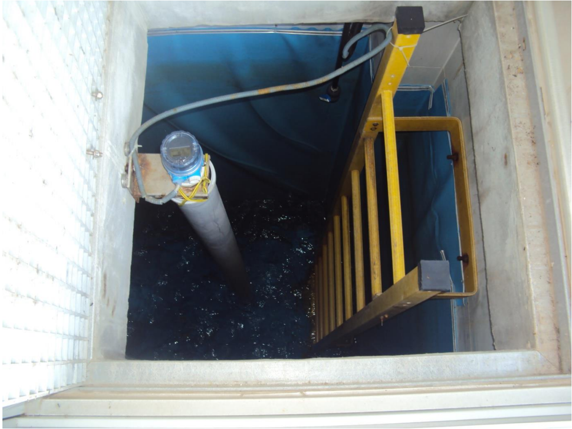
Resim 4. 5. Ön çöktürme haznesi
