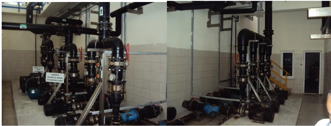
Resim 4. 8. Tesis besleme pompaları ve kum filtreleri geri yıkama pompaları
