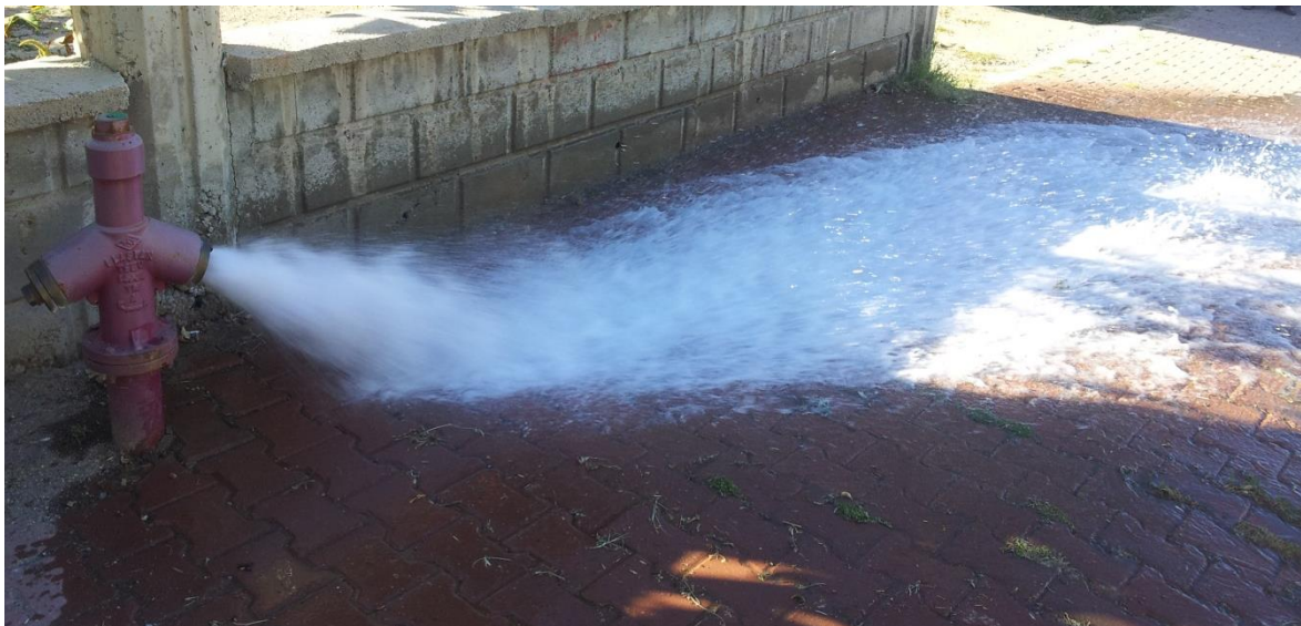
Resim 2.6. Yangın musluğu (yangın hidrantı)
