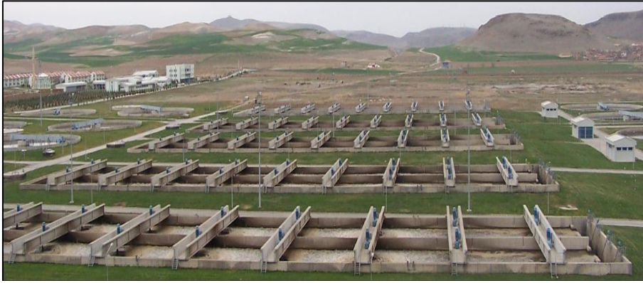
Resim 2.11. Atıksu arıtma havalandırma lagünleri [5]
