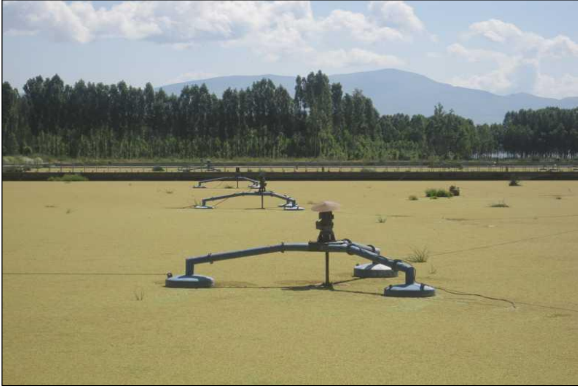
Resim 2.12. Atıksu arıtma yüzeysel havalandırıcılı havalandırma lagünleri [7]
