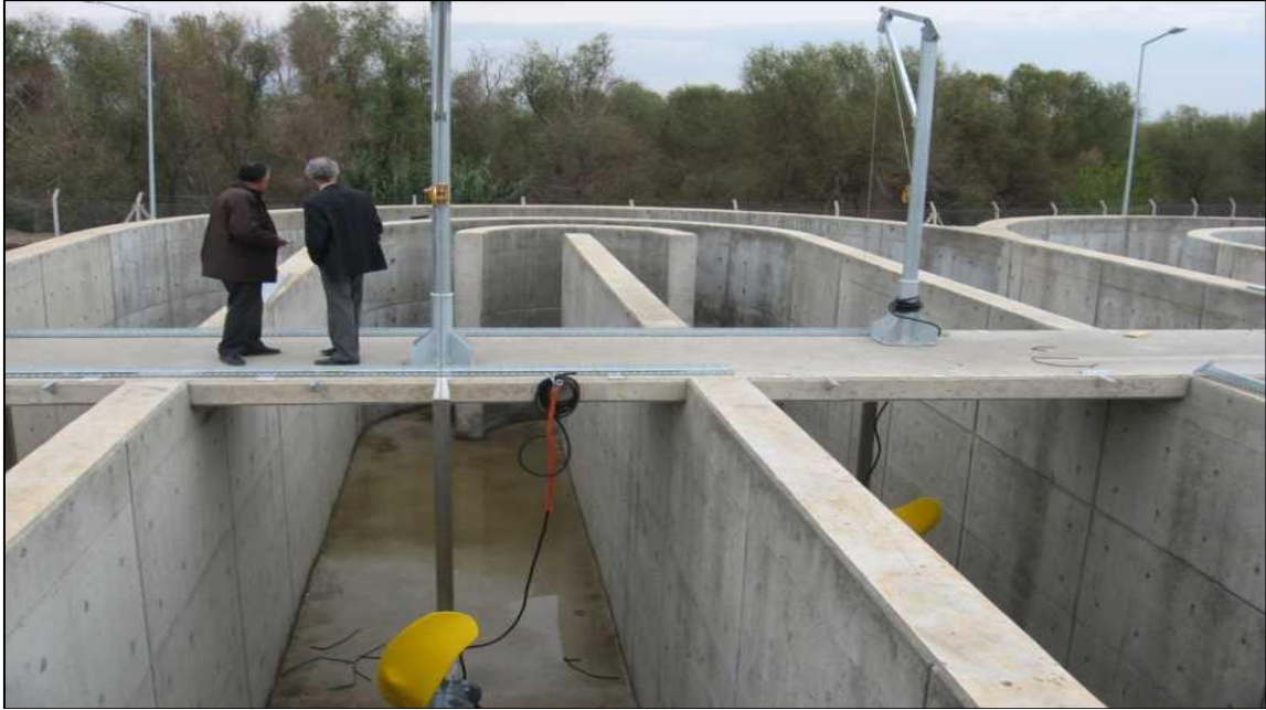
Resim 2.8. Atıksu arıtma muz mikserli havalandırma havuzu [7]
