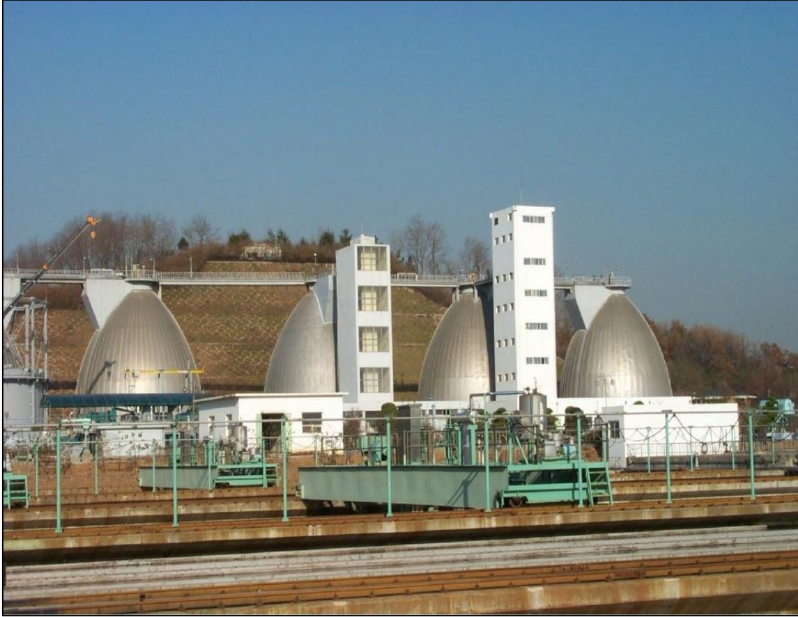
Resim 7.1. Kocaeli 42 evler atıksu arıtma tesisi [67]
