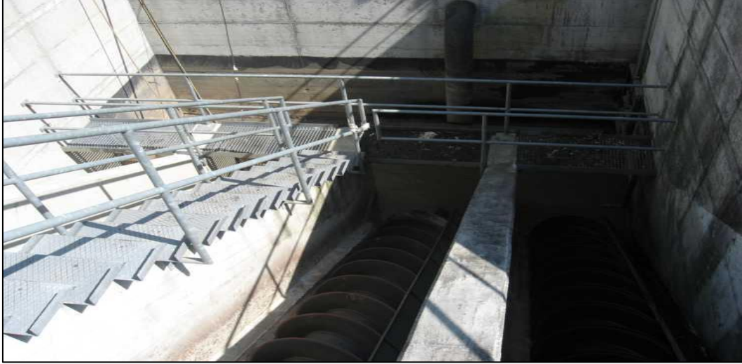
Resim 2.5. Atıksu terfi üniteleri [6]
