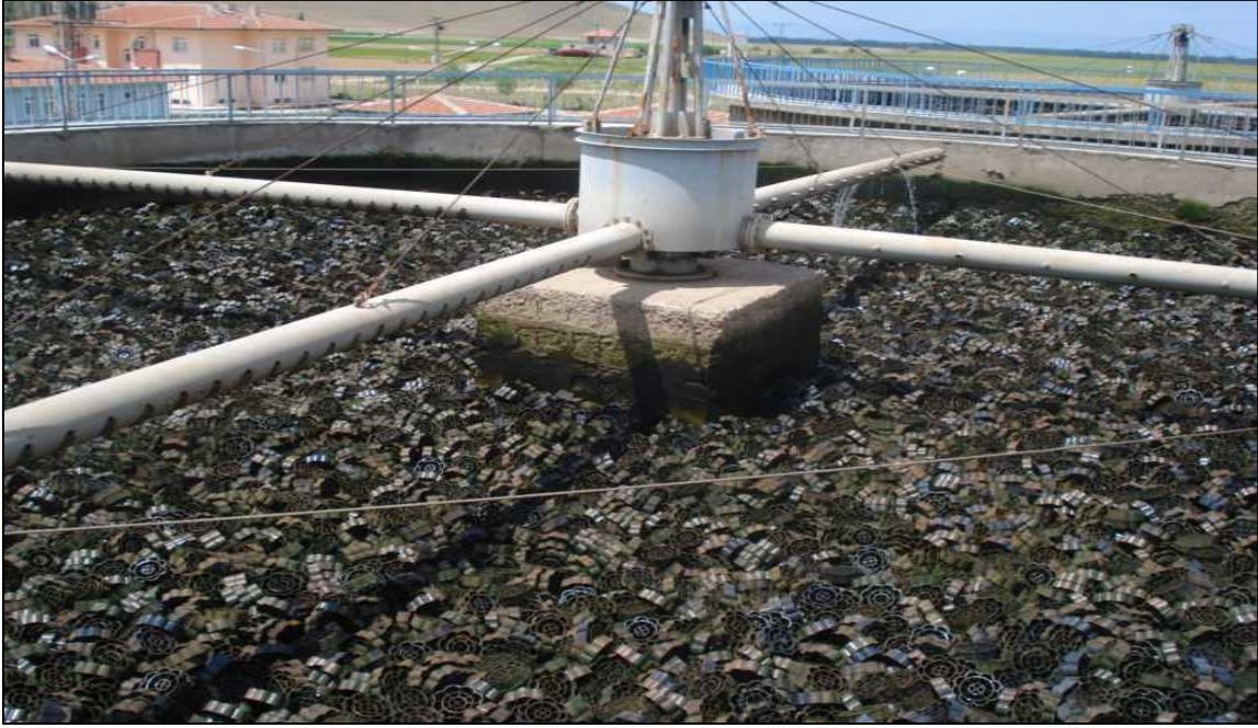
Resim 2.9. Atıksu arıtma damlatmalı filtreler [7]
