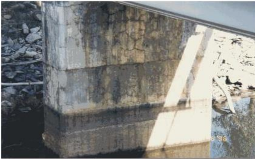
Resim 4.6. Avusturalya'da bir köprü ayağında ASR etkisi sonucu gelişen çatlaklar [36]
