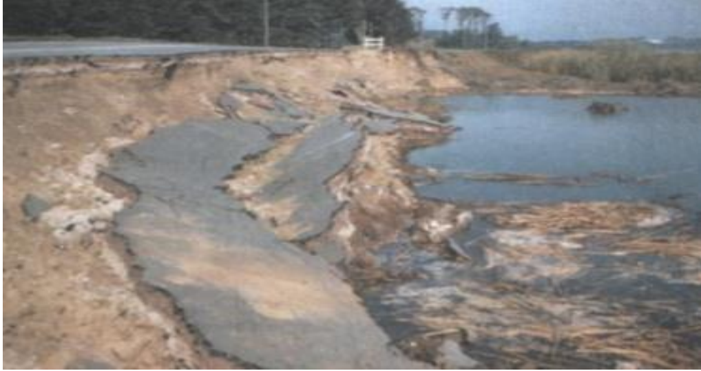
Resim 3.2 San Francisco' daki Merced Gölü Kıyısında Meydana Gelen Akma Göçmesi
