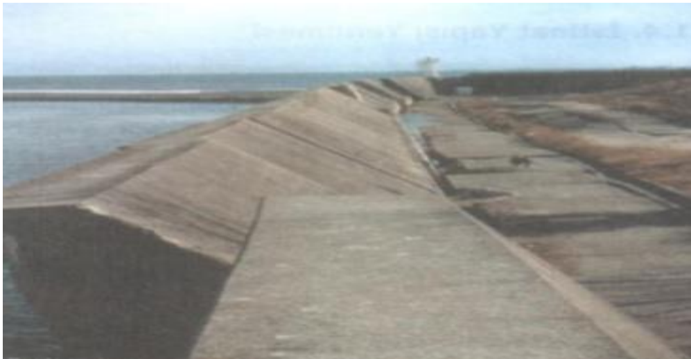
Resim 3.4 Sıvılaşma Sonrası Oluşan İstinat Duvarı Yenilmesi
