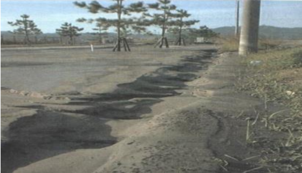
Resim 3.1. 2000 Yılında Meydana Gelen Tottori Depreminde Oluşan Kum Kaynaması
