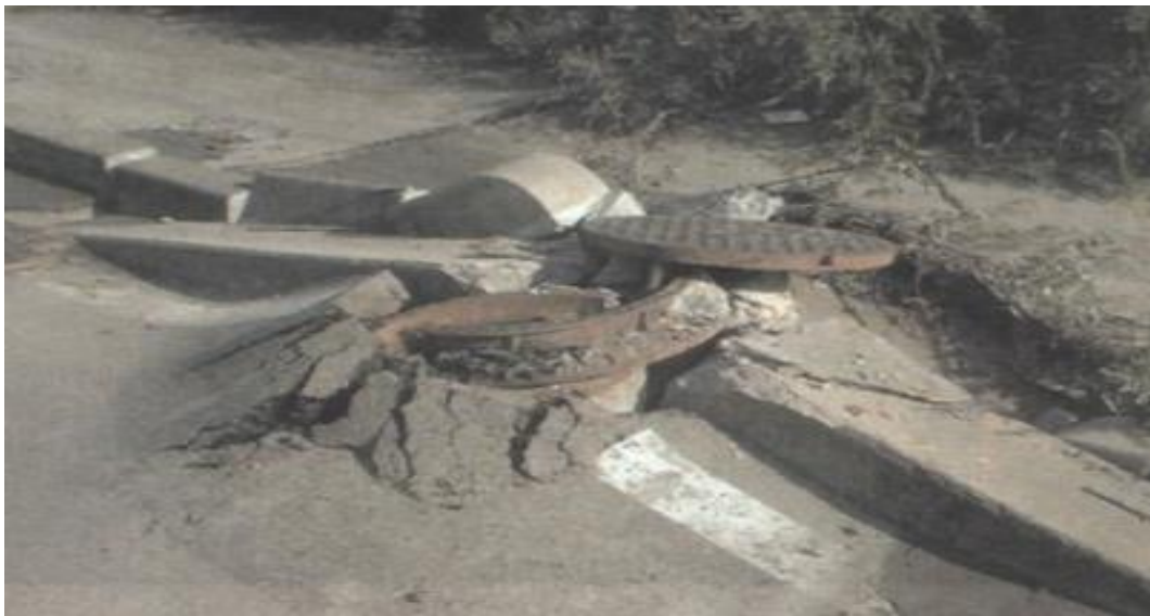
Resim 3.6. Sıvılaşma Sonrası Muayene Bacası Ykselmesi
