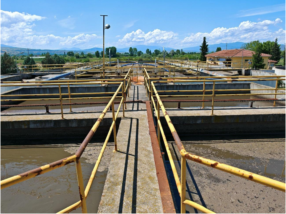
Erbaa AAT Anaerobik ve Havalandırma Tankları
