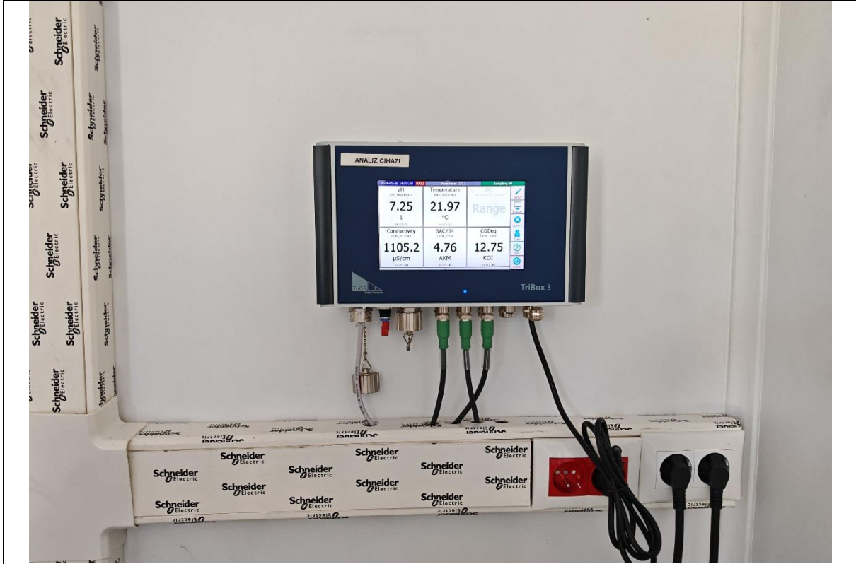
Erbaa AAT Sahasında Sürekli Atıksu İzleme İstasyonunun İçerişi
