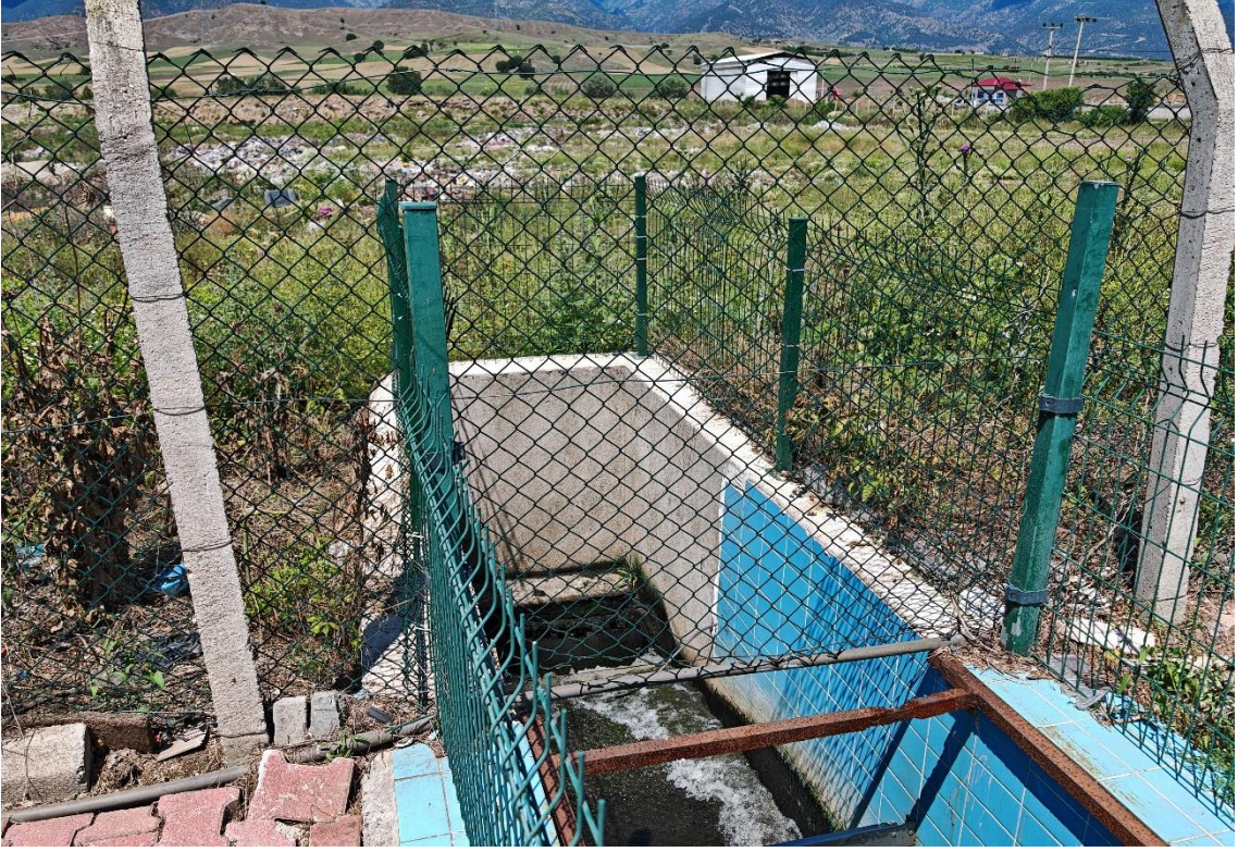
Erbaa Atıksu Arıtma Tesisi deşarj hattı
