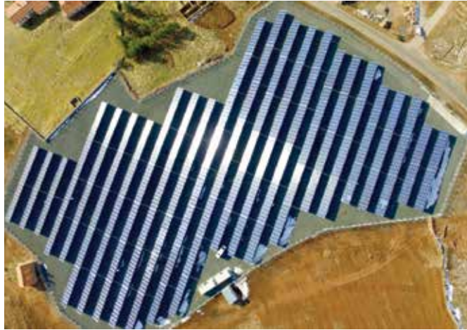
Kayseri Özvatan 990 Kw Gücünde Güneş Enerjisi Santrali
