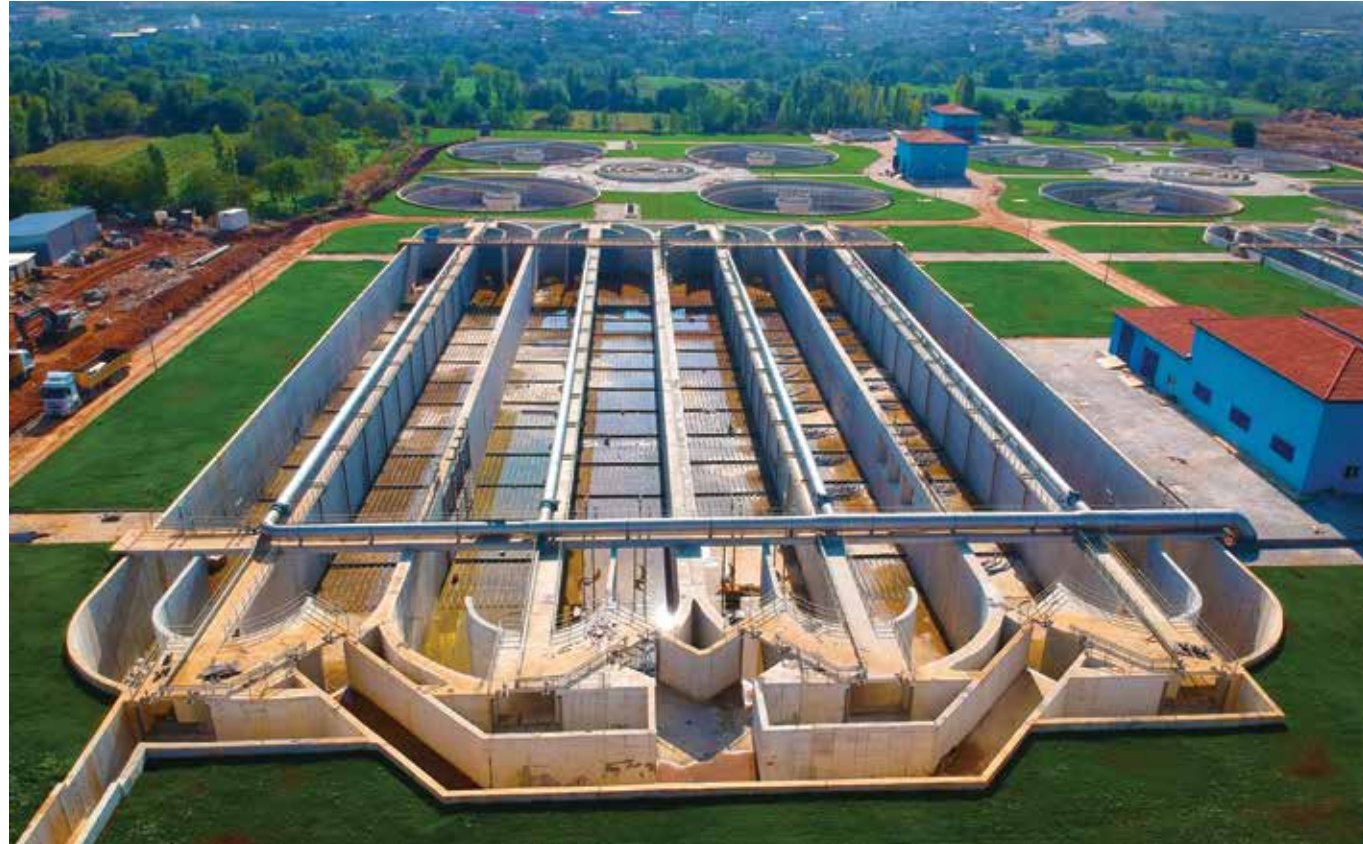
Gaziantep Atık Su Arıtma Tesisi
