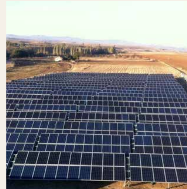
Kırşehir / Kaman, Güneş Enerjisi Santrali
