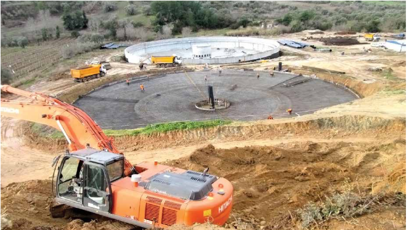
Kuşadası Atıksu Tesisleri
