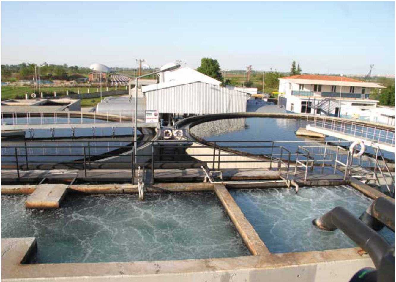
Samsun, Bafra Belediyesi İçmesuyu ve Arıtma Tesisleri
